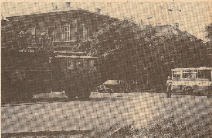
Pracovníci Elektrifikace železnic Praha a Dopravního podniku města Teplic při instalaci nového trolejového vedení na křižovatce Leninova—Vrchlického, která proběhla ve dnech 1. do 8. července. Foto: autor textu
