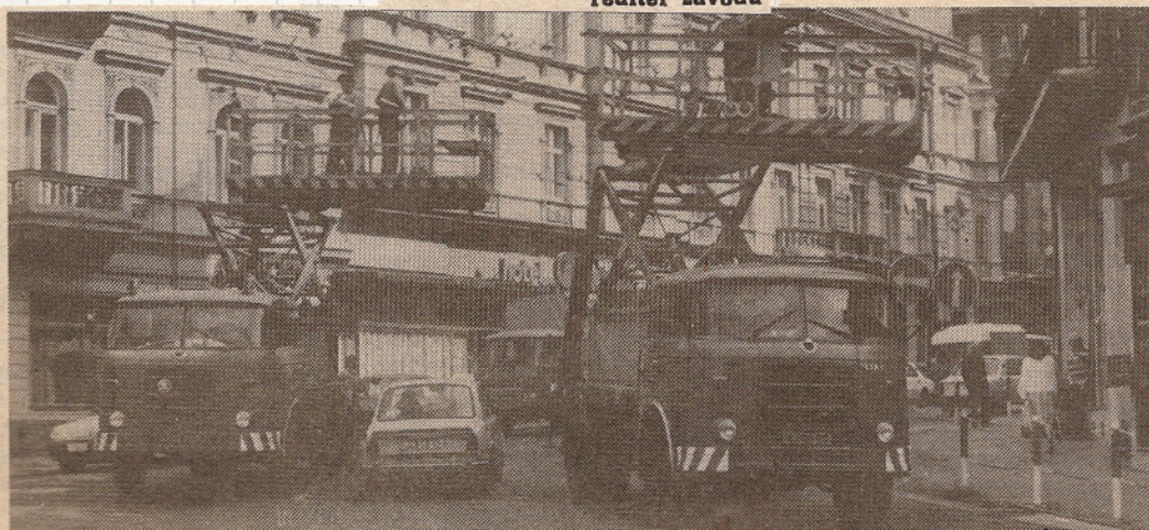
OBJEKTIV Zdeňka Traxlera zachytil ve čtvrtek na Leninově ulici pracovníky Elektrizace železnic Praha otce a syna Křižkových při montáži trolejového vedení.
